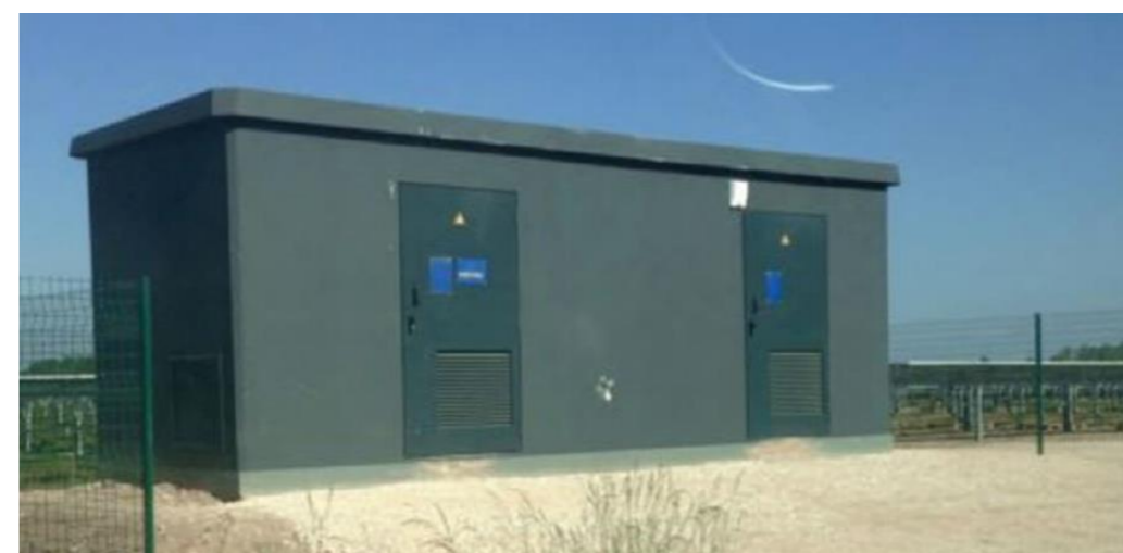
Figure 68 : Exemple d'un poste de livraison
