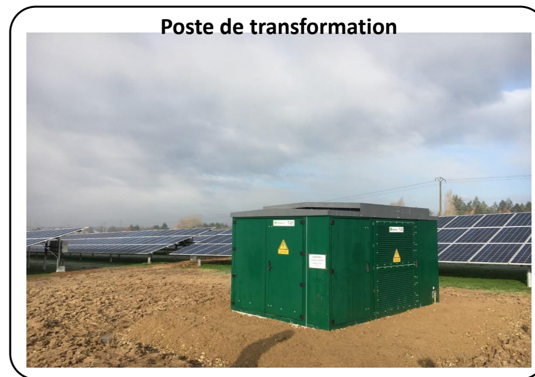
Figure 67 : Poste de transformation
